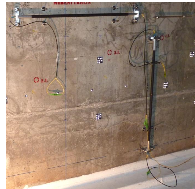
Optovláknový senzor instalovaný na kontejnmentu
